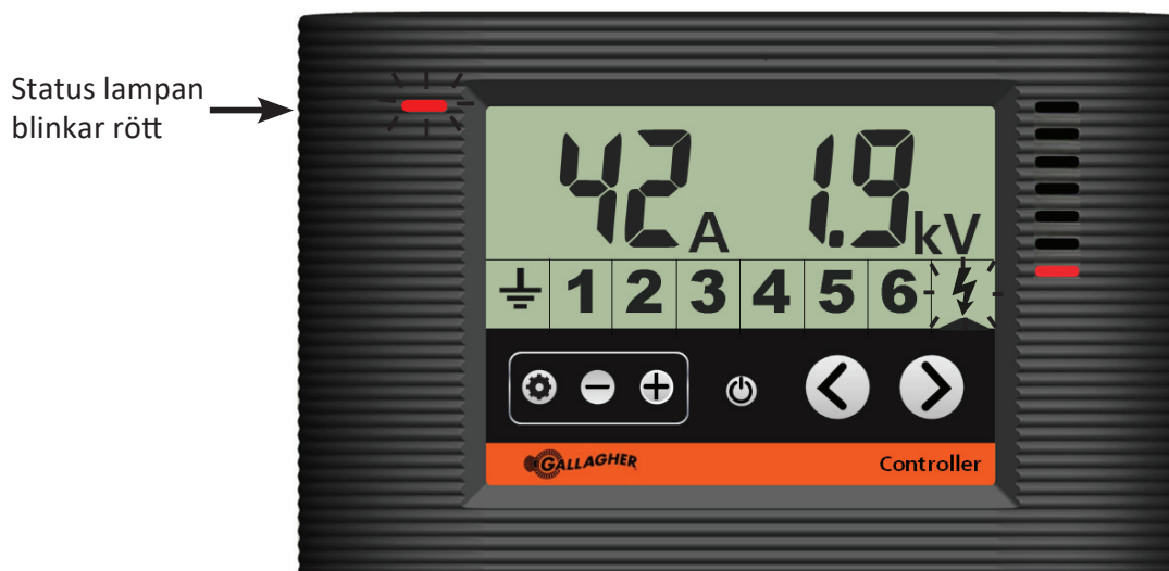
Kontrollen visar aggregat i ström larm
